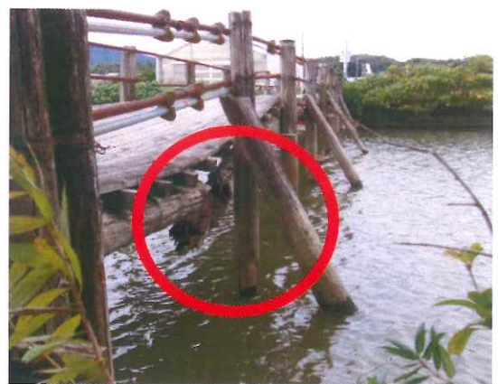
橋桁が折れている
